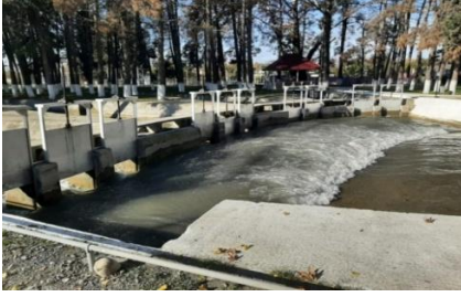
Şəkil 1 . Türyançay kanalı, mexaniki qapılar
